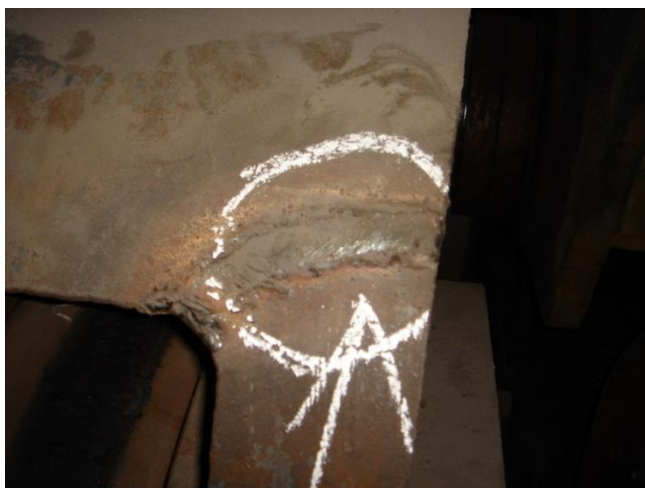
Рис. 1 - Трещина в буксовом узле
